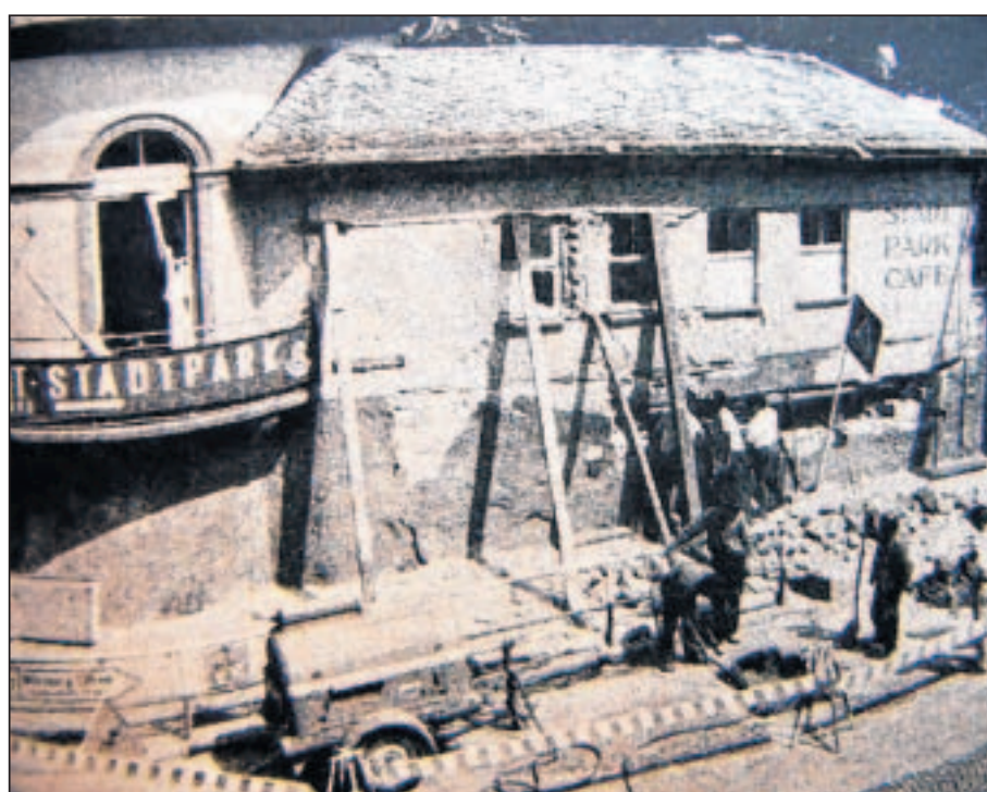
Am 11. Mai 1971, gegen 5.15 Uhr, knallte es am Stadtpark. Eine Gasexplosion zerstörte den Anbau am Moller-Pavillon, der von 1830 datiert. Dort war das Stadtpark-Café. Die neueren Anbauten links und rechts des Pavillons wurden abgerissen.
